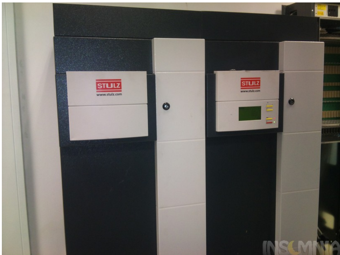
Άλλες δύο κλιματιστικές μονάδες διαφορετικής εταιρείας.
