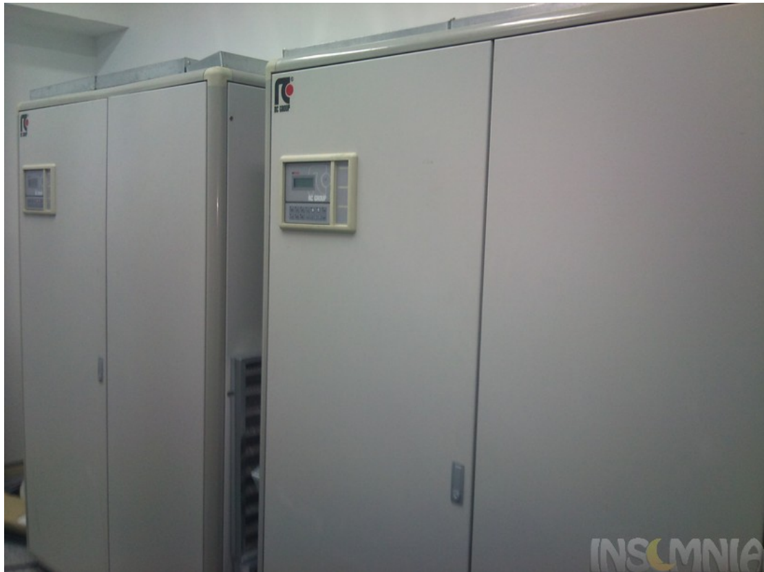
Στην παραπάνω φωτογραφία διακρίνουμε δύο κλιματιστικές μονάδες.
